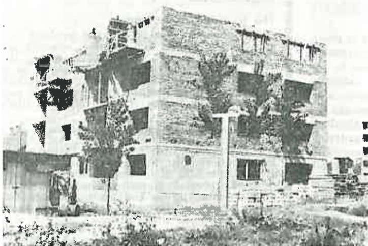
Stambena trokatnica u Cobovićevoj ulici koja se izgrađuje za poduzeće »Gorica«. Predviđeno je 14 stanova veličine 55 m 2 . Ukupna vrijednost zgrade 250.000.000 st. din.
