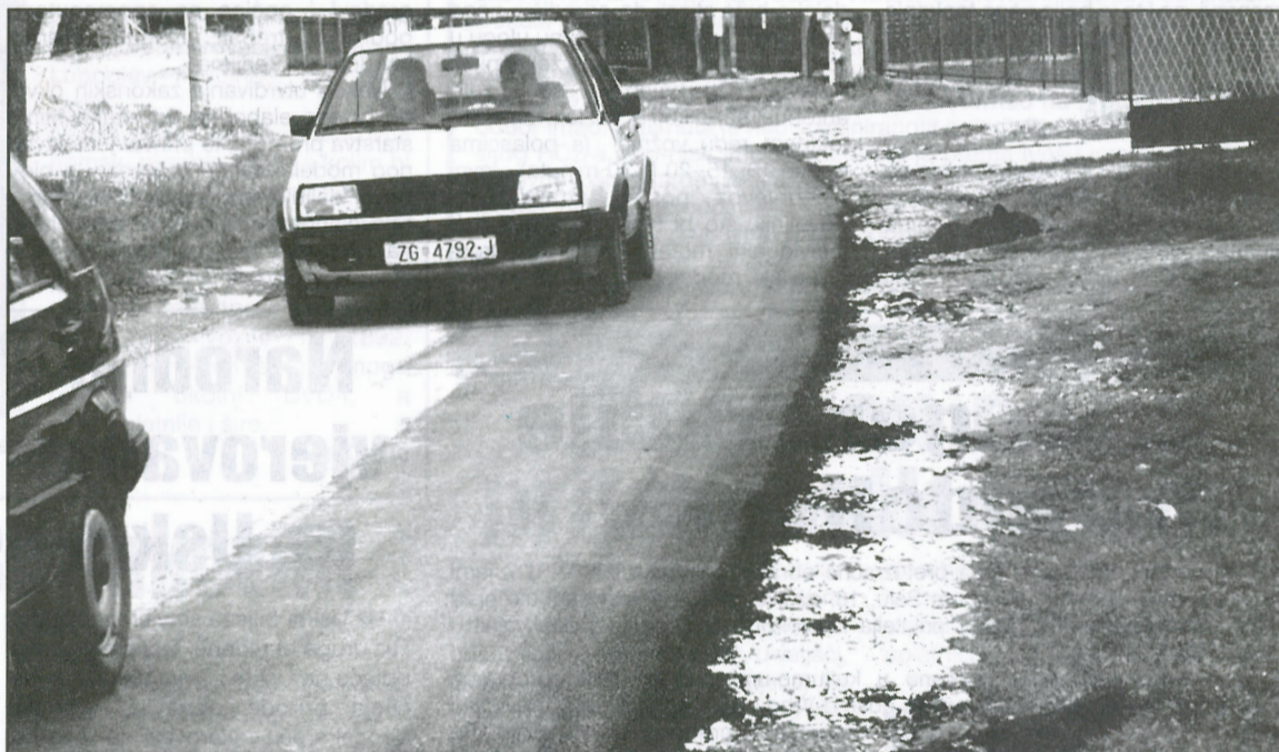
Cesta prema Andrilovcu dijelom je popravljena no pitanje je dokad!
